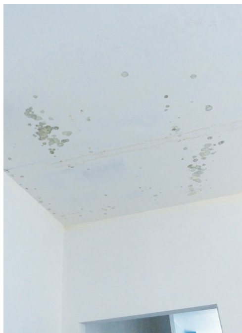
Appartement d'Eliza Tâches d'humidité en formation dans la chambre (2019)
