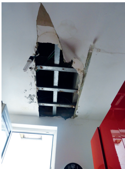
Appartement d'Eliza Plafond effondré dans la cuisine (2019)
